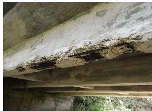
13. 前谷地橋 ：RCT桁橋 (橋長：21.30m、1954年竣工、2級村道) 主桁下面の広範囲な鉄筋露出。 露出鉄筋の著しい断面減少により、耐荷力の低下が推測される。(迂回路有り)
