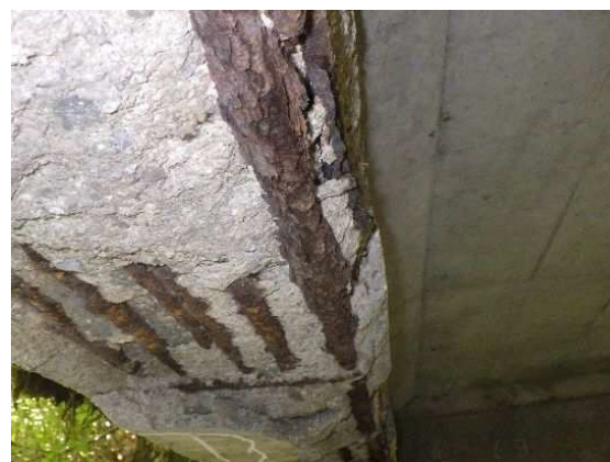
78. 81号橋： RCT桁橋 (橋長：5.60m、1975年竣工) 主桁下面の鉄筋露出、うき。 露出鉄筋の著しい腐食により、耐荷力の低 下が推測される。(迂回路無し)
