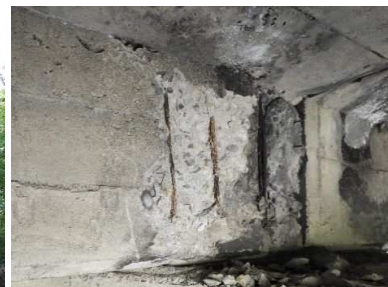
主桁の鉄筋露出
