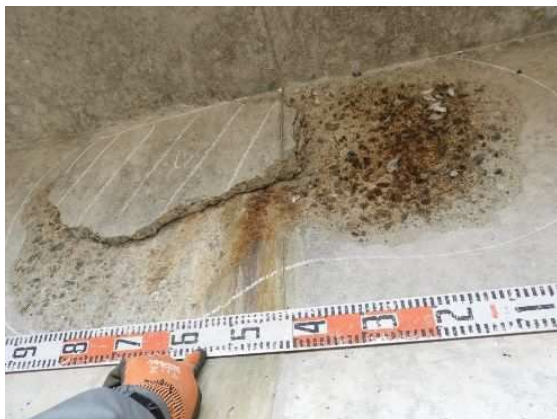
67. 手古岡橋： ポステンT桁橋 (橋長：51.20m、1991年竣工) ポステン桁側面の錆汁、うき、剥離。 内部鋼材の腐食の進行は、耐荷力の低下に 影響する。(迂回路有り)
