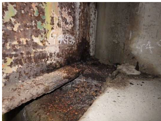
47. 47号橋： RCT桁橋+鋼H桁 (橋長：7.65m、1978年竣工) 主桁端部の著しい腐食。 支点上での残存板厚の減少により、耐荷力 の低下が推測される。(迂回路有り)
