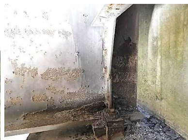
主桁端部の腐食（板厚減少）
