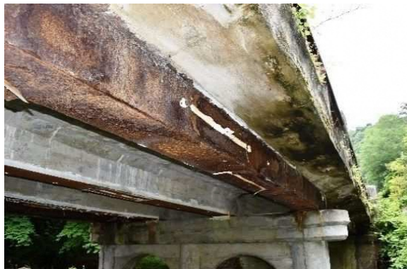
87. 田吾沢橋 ：RCT桁橋 (橋長：15.20m、1934年竣工) 主桁補強鋼板の著しい腐食。 補強部材の著しい腐食により、耐荷力の低下が推測される。(迂回路有り)
