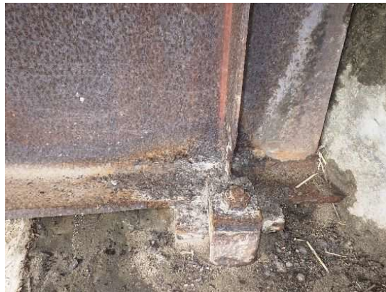
42. 渡橋： 鋼H桁橋 (橋長：14.20m、1972年竣工) 主桁端部の著しい腐食。 支点上での残存板厚の減少により、耐荷力 の低下が推測される。(迂回路無し)
