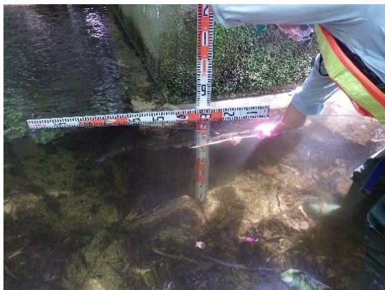
19.19号橋 ：RC床版橋 (橋長：4.05m、1965年竣工、2級村道) 橋台基礎部の著しい洗堀 基礎部の著しい洗堀により、鉛直支持機能の低下が推測される。(迂回路無し)
