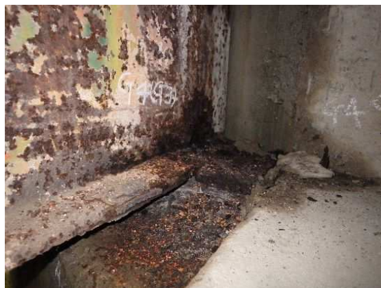
47. 47号橋 ：RCT桁橋+鋼H桁 (橋長：7.65m、1978年竣工) 主桁端部の著しい腐食。 支点上での残存板厚の減少により、耐荷力 の低下が推測される。(迂回路有り)
