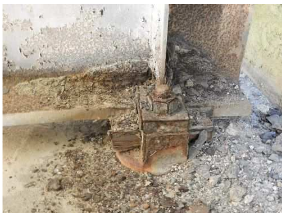
27. 宮の下橋 ：鋼H桁橋 (橋長：54.40m、1973年竣工、2級村道) 主桁端部の著しい腐食。 支点上での残存板厚の減少により、耐荷力 の低下が推測される。(迂回路有り)
