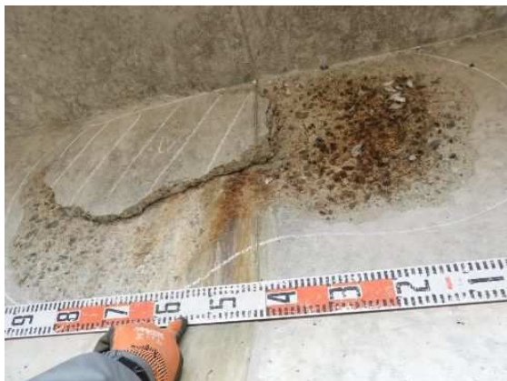
67. 手古岡橋 ：ポステン桁橋 (橋長：51.20m、1991年竣工) ポステン桁側面の錆汁、うき、剥離。 内部鋼材の腐食の進行は、耐荷力の低下に 影響する。(迂回路有り)
