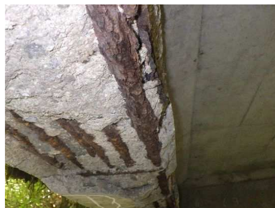
78. 81号橋 ：RCT桁橋 (橋長：5.60m、1975年竣工) 主桁下面の鉄筋露出、うき。 露出鉄筋の著しい腐食により、耐荷力の低 下が推測される。(迂回路無し)
