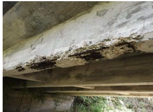
13. 前谷地橋 ： RCT桁橋 (橋長：21.30m、1954年竣工、2級村道) 主桁下面の広範囲な鉄筋露出。 露出鉄筋の著しい断面減少により、耐荷力の低下が推測される。(迂回路有り)
