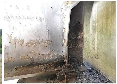
主桁端部の腐食（板厚減少）
