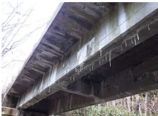
59. 61号橋 ： RCT桁橋 (橋長：12.60m、1960年竣工) 主桁全面の遊離石灰を伴うひびわれ。 雨水の浸入により、内部鉄筋の腐食が進行する可能性が高い。(迂回路有り)
