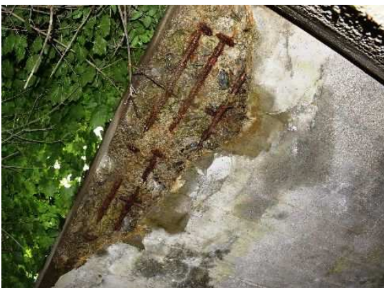
88. 鍋倉橋 ：RC床版橋 (橋長：5.40m、1963年竣工、2級村道) 床版下面の鉄筋露出、遊離石灰。 露出鉄筋の著しい腐食により、耐荷力の低 下が推測される。(迂回路有り)
