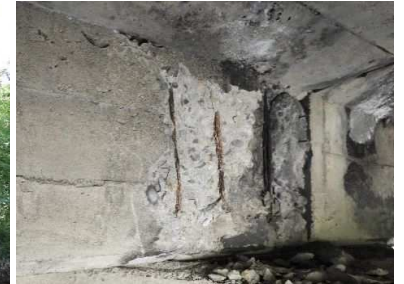
主桁の鉄筋露出
