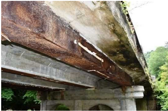
87. 田吾沢橋 ： RCT桁橋 (橋長：15.20m、1934年竣工) 主桁補強鋼板の著しい腐食。 補強部材の著しい腐食により、耐荷力の低下が推測される。(迂回路有り)
