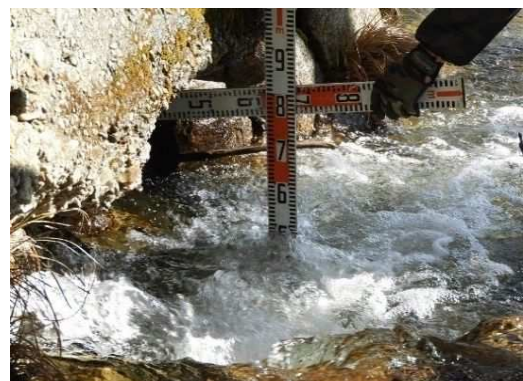
84. 子安川橋 ： RCT桁橋 (橋長：18.07m、1933年竣工) 橋台基礎部の著しい洗堀。 基礎部の著しい洗堀により、鉛直支持機能の低下が推測される。(迂回路有り)
