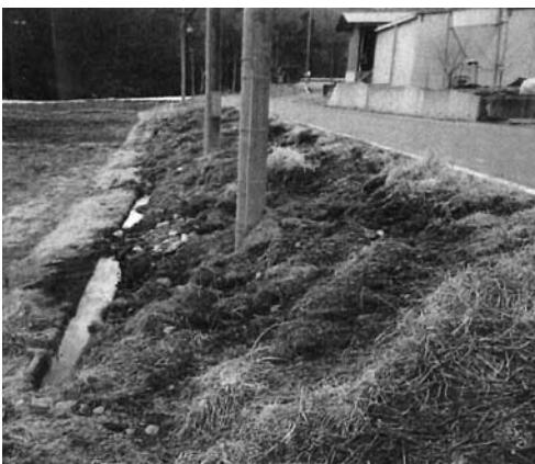
イノシシ被害にあった林道法面
